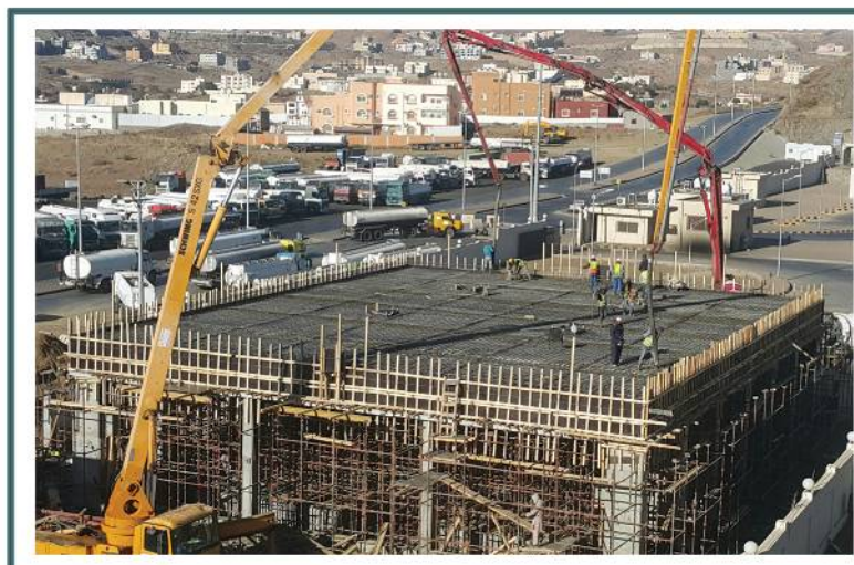
محطة شمال أبها
